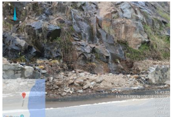
Đoạn 17 Sụt lở, đá lăn, hư hỏng tường chắn vị trí S29 (taluy dương)
