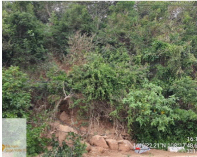
Hình 2.23. Khối xói sạt S20 đoạn 12
