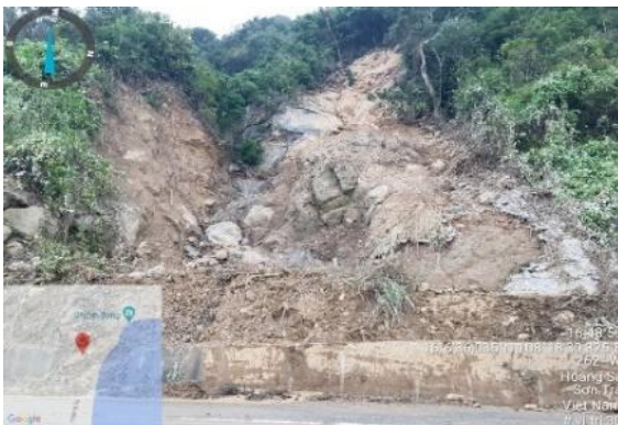
Đoạn 18 Xói sụt vị trí S30 (Đá lăn taluy dương)
