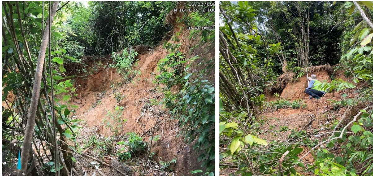
Hình 2.8. Vị trí khối xói sụt có tọa độ X=555698.196 Y=1780785.875 tại đoạn 1.
