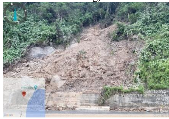
Đoạn 18 Sụt lở vị trí S31 (taluy dương)
