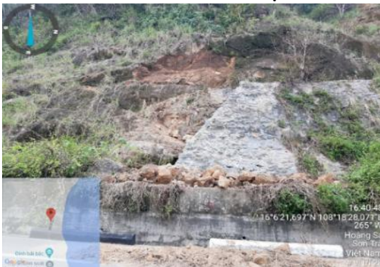
Đoạn 16 Sụt lở vị trí S28 (taluy dương)
