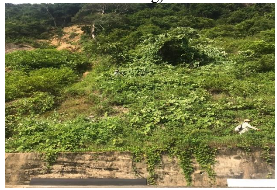
Đoạn 18 Xói sụt vị trí S31 (Đá lăn taluy dương)
