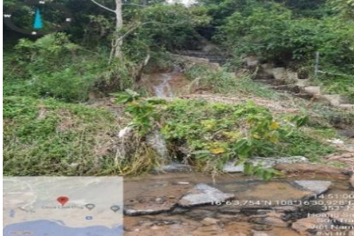
Đoạn 2 Xói sụt tại vị trí S3 (Đá lăn taluy)
