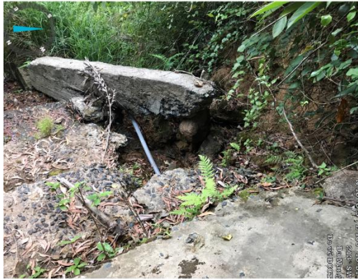
Hình 2.11. Xói sạt ở vị trí S3 đoạn 2.
