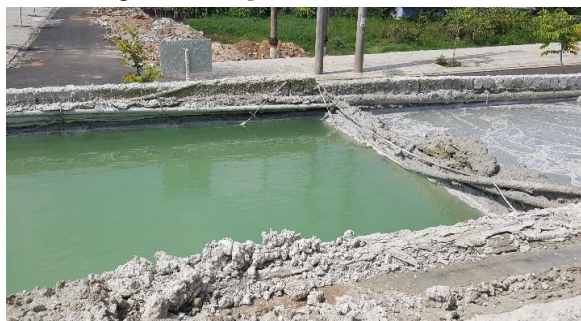
Hình 1. Bể lắng của một trạm trộn bê tông xỉ măng ở thành phố Đà Nẵng
